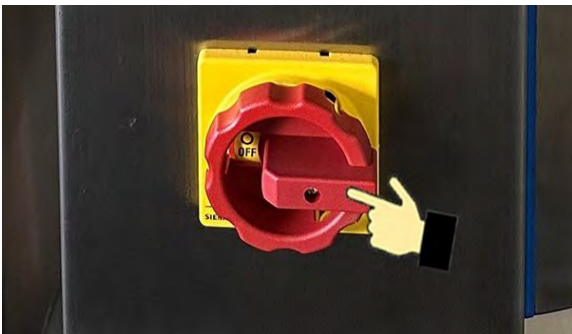
Abbildung 59: Hauptschalter am Bedienfeld ausschalten
